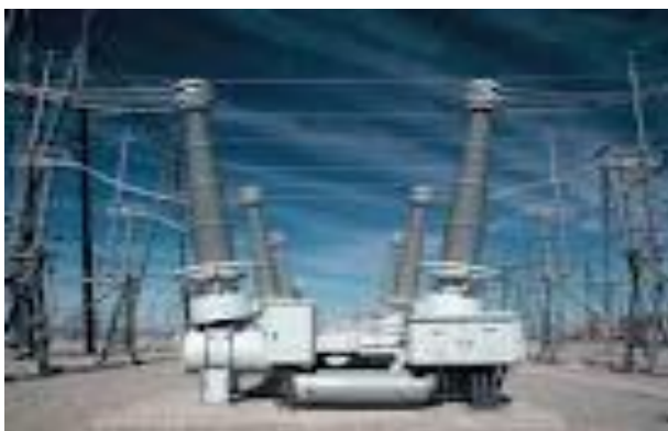
Рис. 1 – Открытые распределительные устройства подстанции
